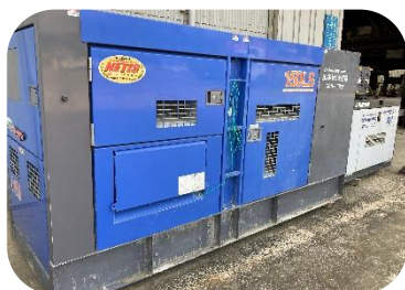
発電機の軽油使用
